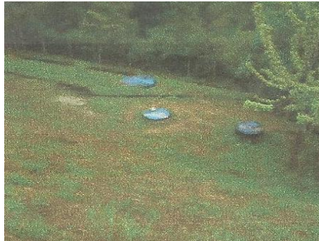
Figura 6: Tratamento anaeróbico dos efluentes
